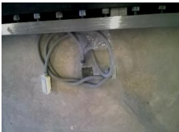
Tomacorriente destinado para la unidad (des energizado)
