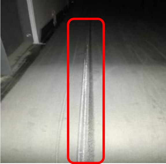
Daño grave sobre cinta transportadora
