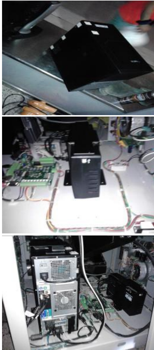
Estado interno luego del mantenimiento
