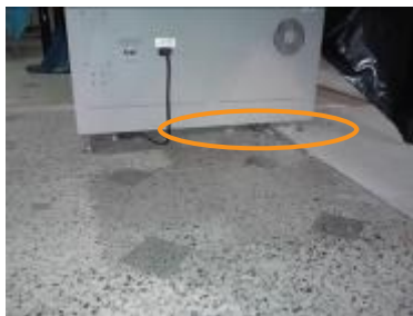
Restos de concreto debajo de la unidad
