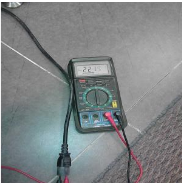
Suministro Eléctrico PDMT (14:30)
