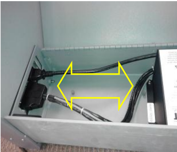
Comprobación de cableado y conectores
