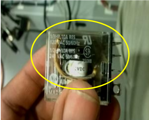
Rele de la unidad, contactos sulfatados
