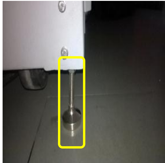
Patas (4) niveladoras de unidad dobladas
