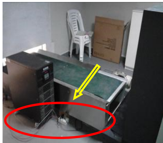
Suministro eléctrico alto peligro
