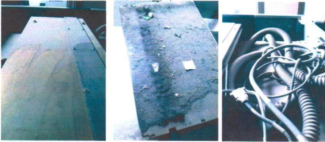
Limpeza a medio terminar, Suciedad acumulada y Cables desordenados
