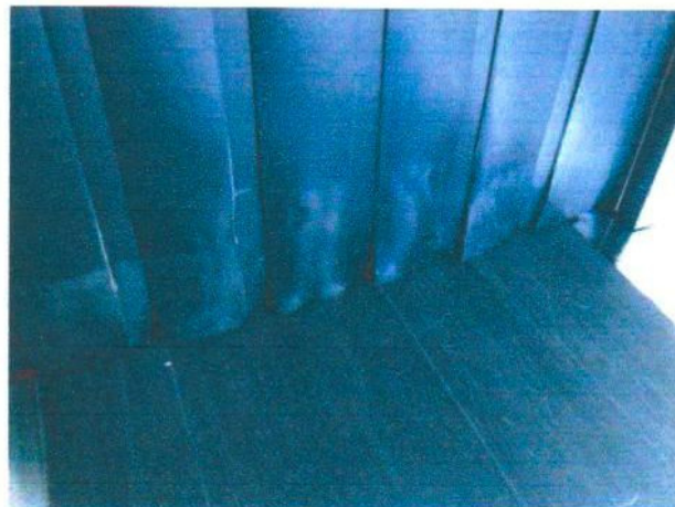
Estado de cortinas, NO TIENE FUGA pero requieren cambio
